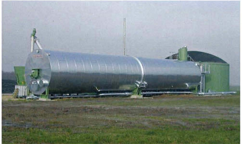
In diesen beiden Gärräumen arbeiten die Bakterien. Links im Bild der liegende Hauptfermenter.
