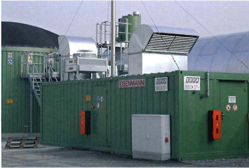
Der Container mit dem Blockheizkraftwerk
