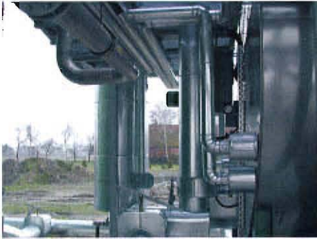
Auch bei der Biogaserzeugung ist viel Technik im Spiel
