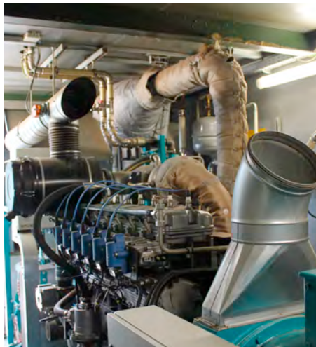
Biogasmotor im Container
