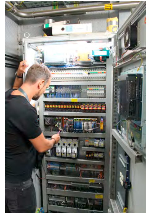
Wartung der Elektronik
